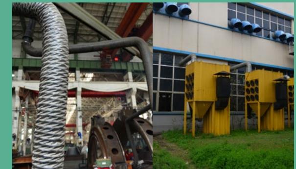
新增的焊接废气除尘装置
