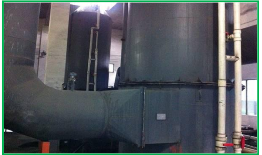
锅炉烟气处理设施
