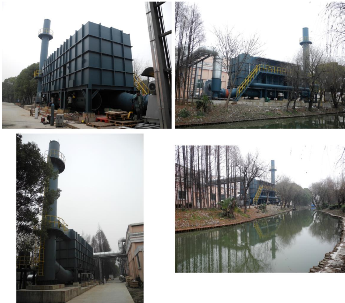
VOCs 排放治理设备
