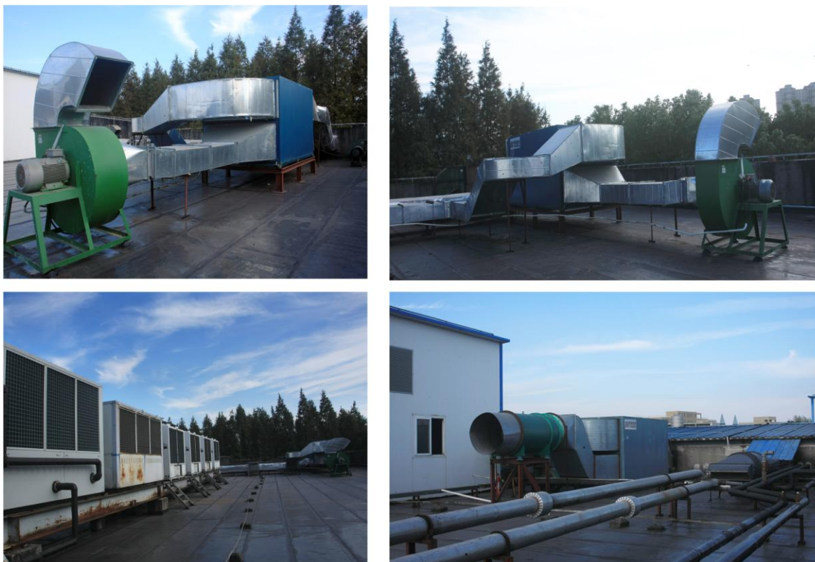
大型废气噪音吸附隔离装置
